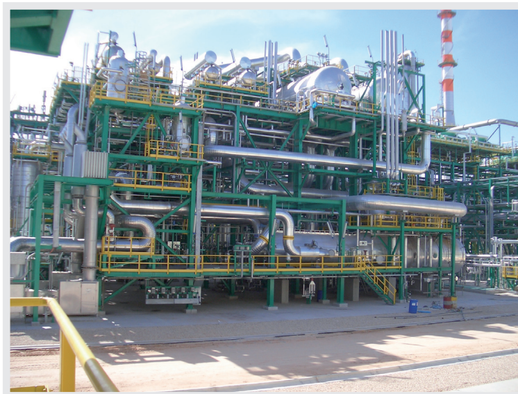
Fig. 5 – Mellitah (Libia), 2000, impianto per la purificazione di gas naturale destinato al mercato italiano tramite il gasdotto Green
