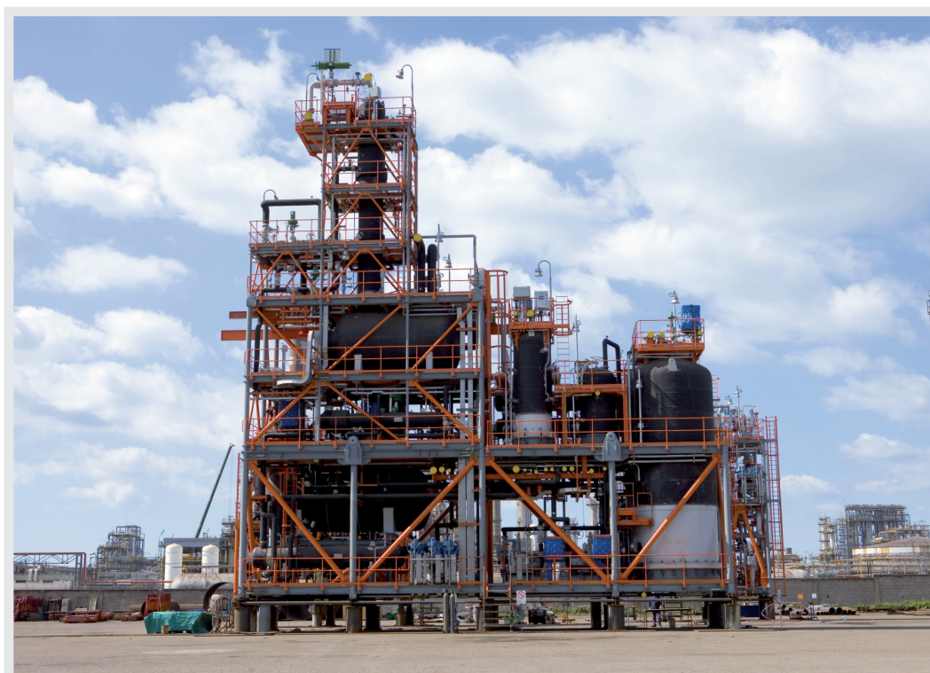
Fig. 7 – Kazakistan, 2006, impianto di disidratazione per il campo oil & gas di Kashagan
